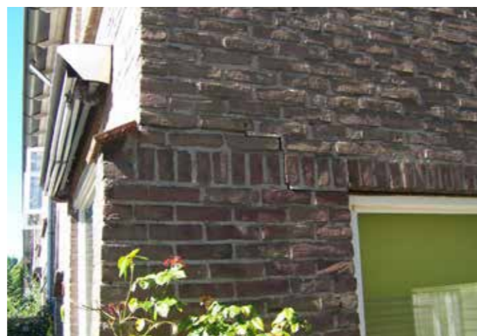
Voorbeelden van schade aan metselwerk in deelplan Zuid
